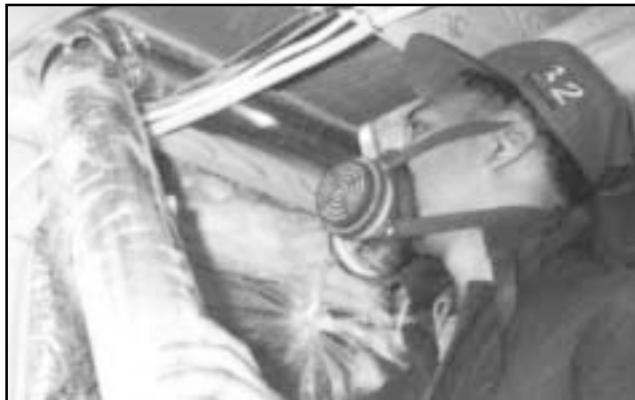
Los conductos de calefacción y aire acondicionado pueden acumular polvo que contiene plomo.
